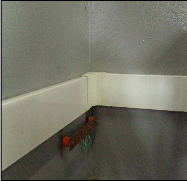
Figura 06-Exemplo de caneleta com fiação elétrica e lógica.
