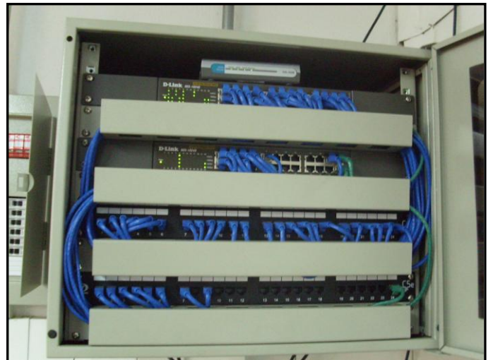
Figura 09- Exemplo de rack para o modem e switches
